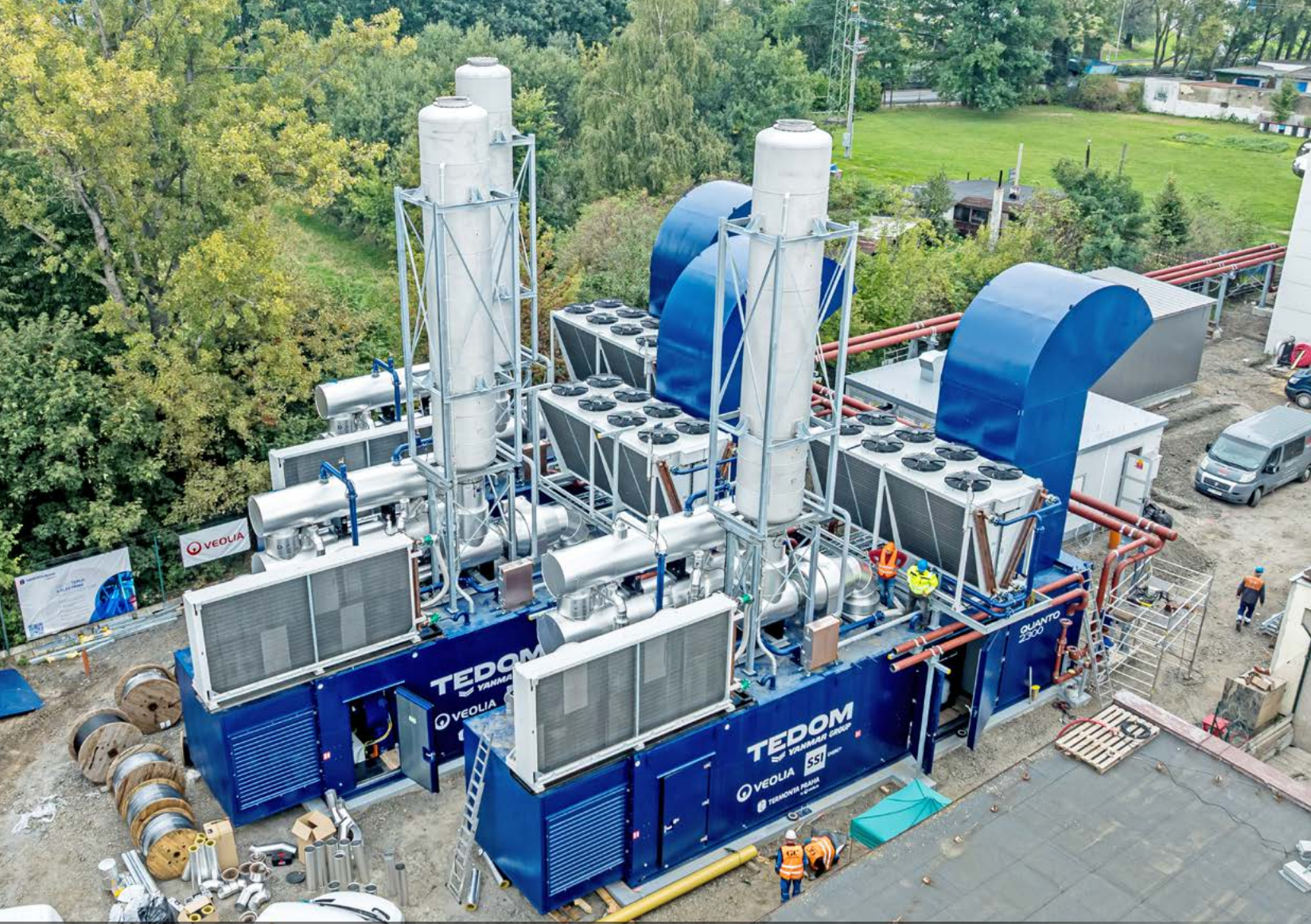
Jeden z největších kogeneračních projektů poslední doby: Tři jednotky o celkovém výkonu 6,9 MW pro zásobování teplem i elektřinou místního sídliště. One of the largest cogeneration projects in recent years: three units with a total capacity of 6.9 MW supplying heat and electricity to a local residential district.
